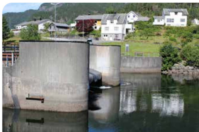
Dammen ved Osvad. Minstevannføringen i Suldalslågen gjennom hele året styres via denne dammen. Det skal nå utredes om dammen påvirker opp- og nedvandring av fisk, samt gytemuligheter i området for laks og storaure fra Suldalsvatnet.
