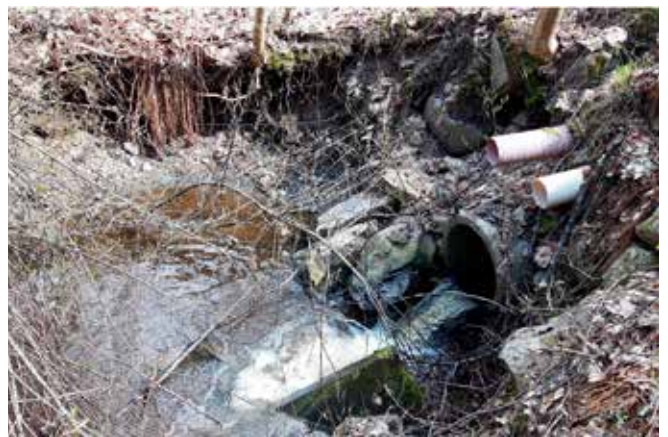
Før stensetting, kulpen har tydelige tegn på utgraving
