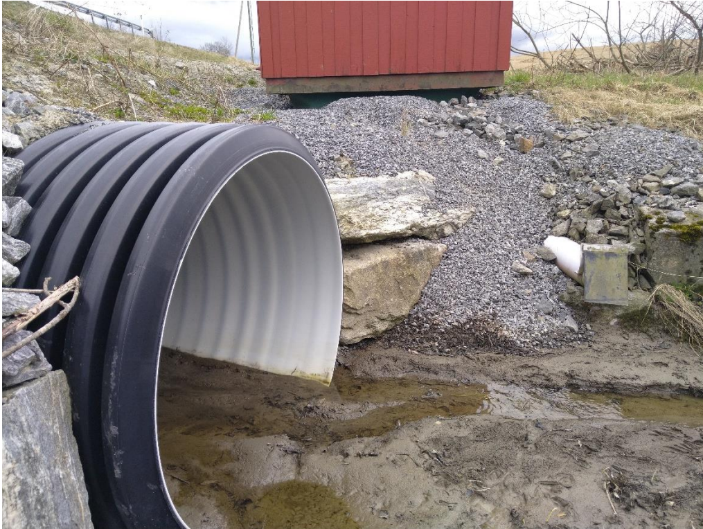
Figur 1 Tydelig stor transport av leire/silt ved utløpet av rør nummer to under Båstadveien.
